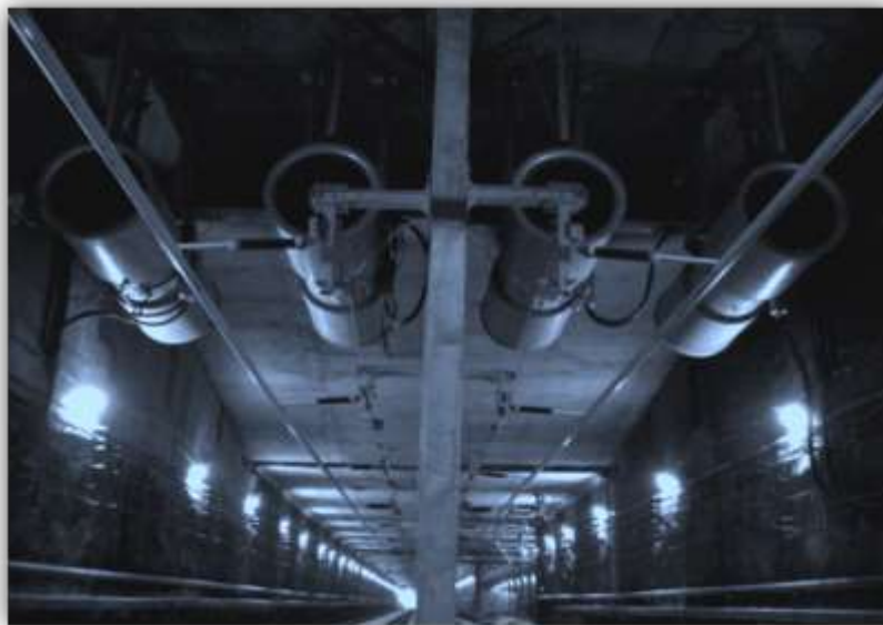
Tunnel Booster Fan
